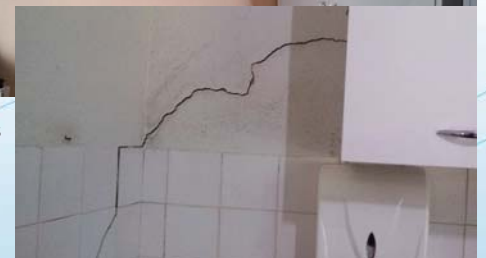
Paredes estão trincadas e equipamentos são antigos e precários
